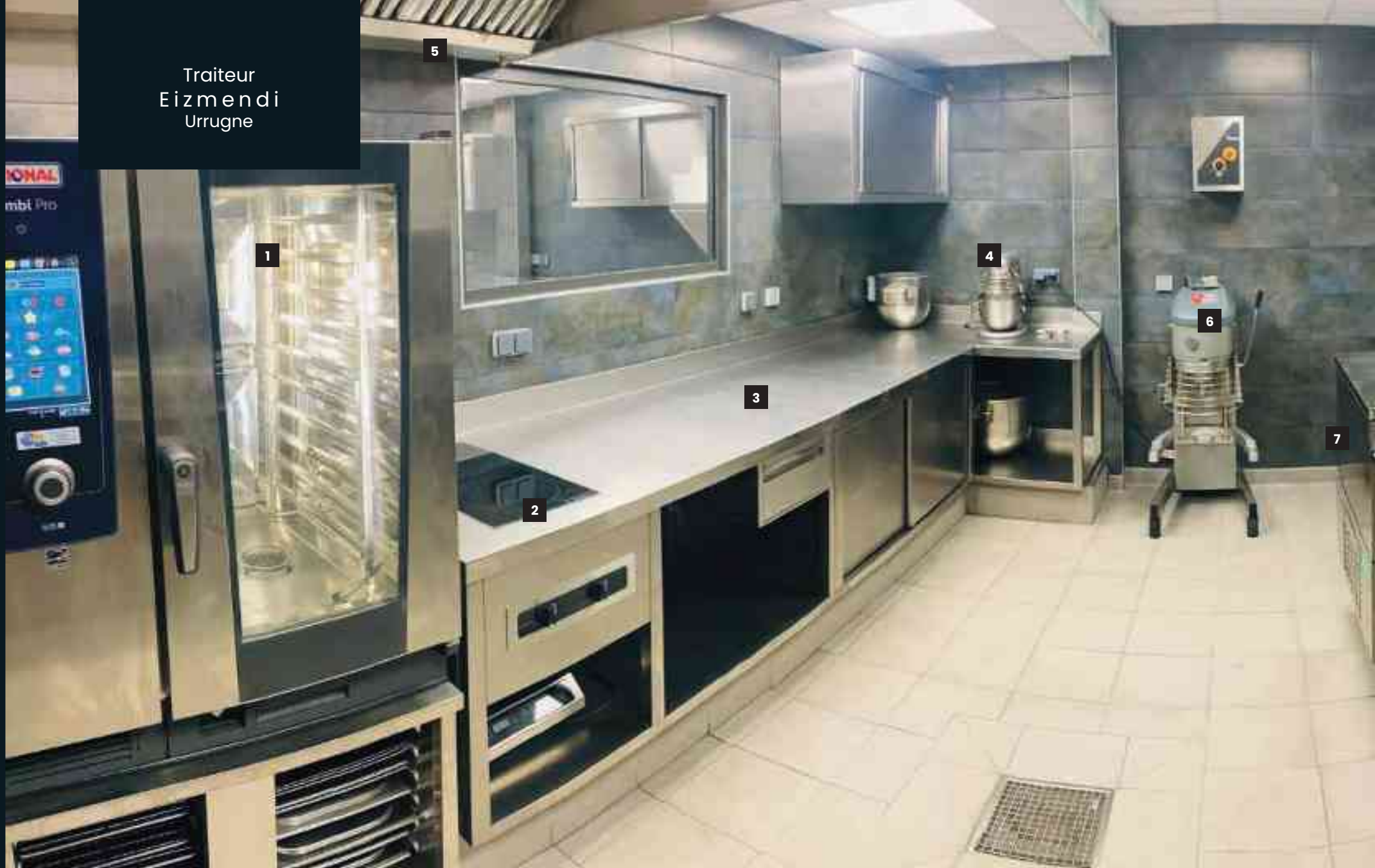
1 Four mixte RATIONAL 2 Plaque à induction 3 Inox sur mesure 4 Batteur KITCHENAID 5 Plafond filtrant ALVENE 6 Batteur SAMMIC 7 Cellule de refroidissement TECNOMAC
